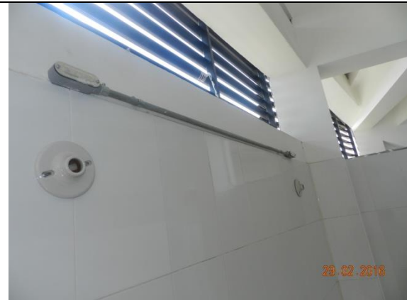
Ductos y cajas metálicas en instalaciones eléctricas
