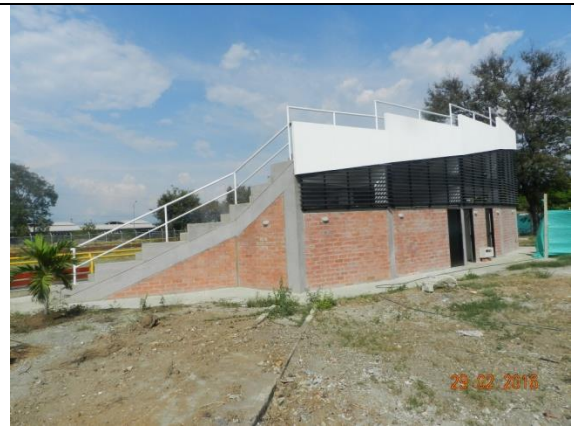
Camerinos, panorámica estructura en concreto reforzado, ladrillo a la vista, puertas metálicas, celosía metálica, lámparas, andenes perimetrales
