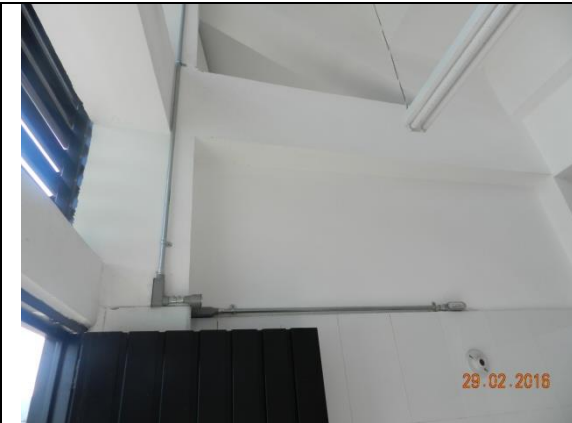
Ductos y cajas metálicas en instalaciones eléctricas
