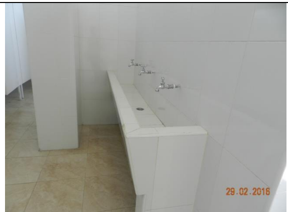
Camerinos hombres, lavamanos en concreto enchapado, piso en baldosa de cerámica, pintura de muros
