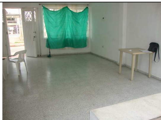
Salón principal, pisos en baldosa de grano pulido, mampostería ladrillo común, puertas y ventanas metálicas, acabado estuco y pintura viniltex,
