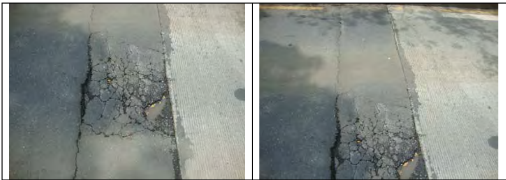
Cra100 frente a McDonald: Fisura en losa a unos 100 mts de la estación Buitrera, carril sur norte.
