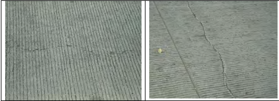
CI15 – Cra80: Fisura de losa comprende 40 mts, carril norte sur.
