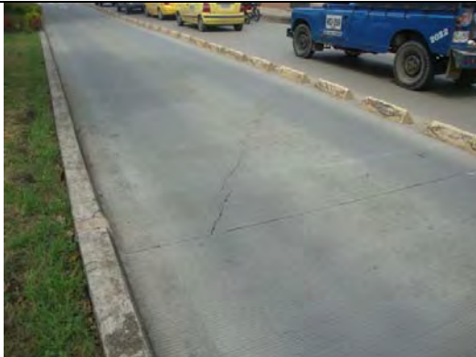
Calzada occidental carril sólo bus, frente al N° 73-39. Fractura de losa de concreto
