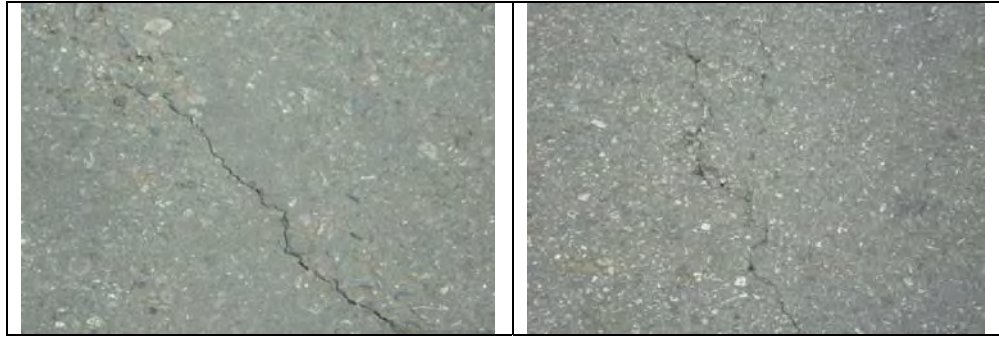
Cra100 # 11 – 90: Fractura de losa donde empalma concreto con asfalto carril sur norte al frente de Unicentro.
