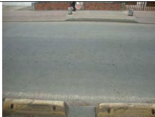
Calzada occidental carril mixto frente al N° 71A-123. Fractura de losa de concreto
