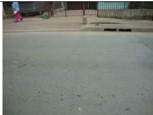
Calzada occidental carril mixto, frente al N° 74-17. Fractura de losa de concreto
