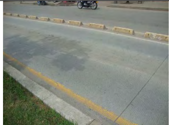
Calzada occidental carril sólo bus, frente al N° 72A-31. Fractura de losa de concreto
