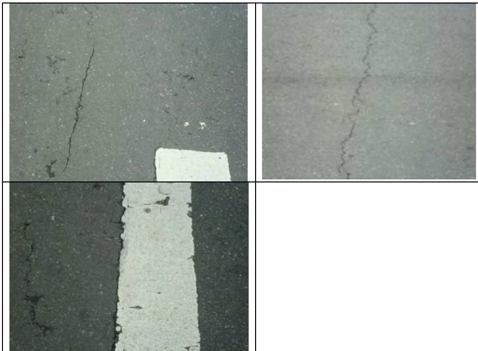
CI15 – Cra65: Losa deteriorada, frente a banco AV Villas, carril norte sur.
