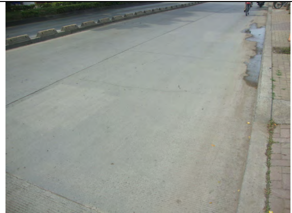
Calzada occidental carril mixto, frente al N° 71A-155. Fractura de losa de concreto
