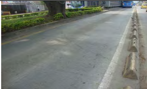
Calzada occidental carril sólo bus frente al N° 71A-155. Fractura de losa de concreto
