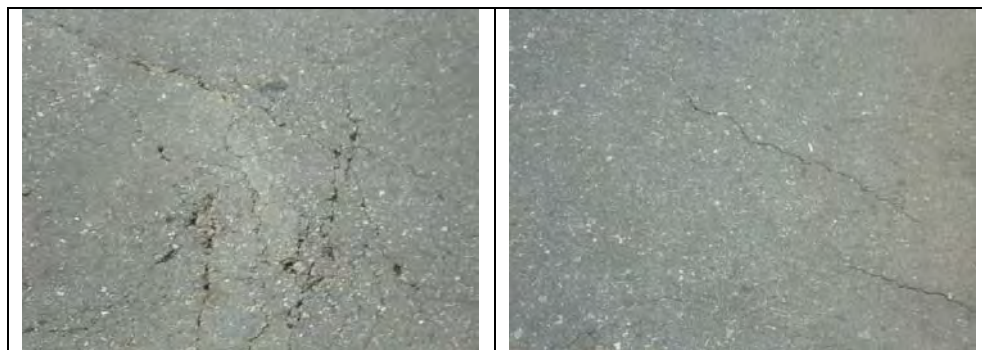
Cra100 # 12 – 90: Fisura en losa en ambas carriles frente Mazda.
