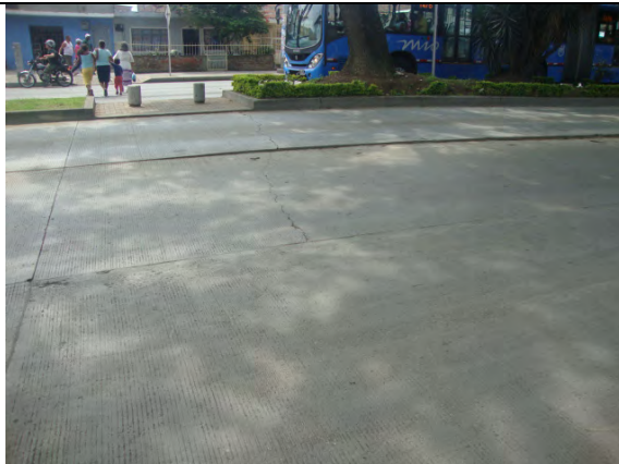
Calzada occidental frente al N° 71A-191. Fractura de losas de concreto en el carril sólo bus y en el carril mixto
