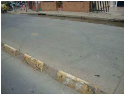
Calzada occidental carril mixto, frente al N° 73-31. Fractura de losa de concreto
