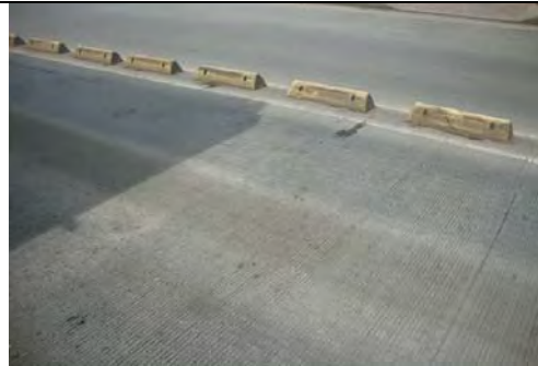
Calzada occidental carril sólo bus frente al N° 71A-123. Fractura de losa de concreto
