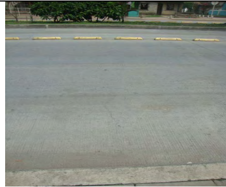
Calzada oriental carril mixto, frente al N° 74-54. Fractura de losa de concreto
