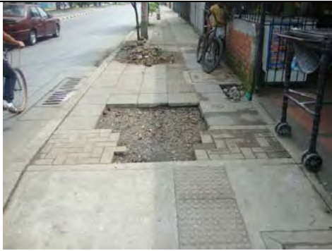
Calzada oriental, espacio público frente al N° 74-04. Retiro y falta de reposición de baldosas de concreto y de adoquines
