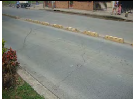
Calzada occidental carril sólo bus, frente al N° 73-31. Fractura de dos losas de concreto
