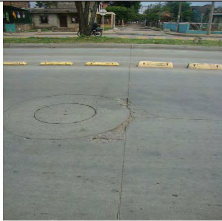
Calzada oriental carril mixto, frente al N° 74-74. Pérdida de concreto y fractura de esquina de solas contiguas a cámara de inspección
