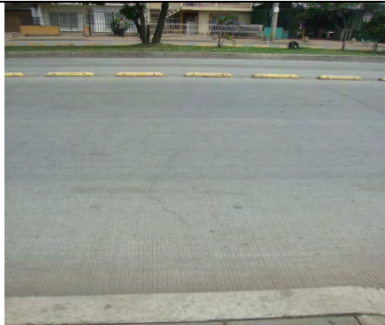
Calzada oriental carril mixto, frente al N° 74-46. Fractura de losa de concreto
