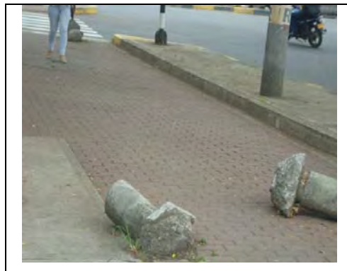
CII5 – Cra27: Losa de vía en concreto en la junta de, losa en paso peatonal en adoquín está fracturada frente a Quinta pan, carril sur norte.
