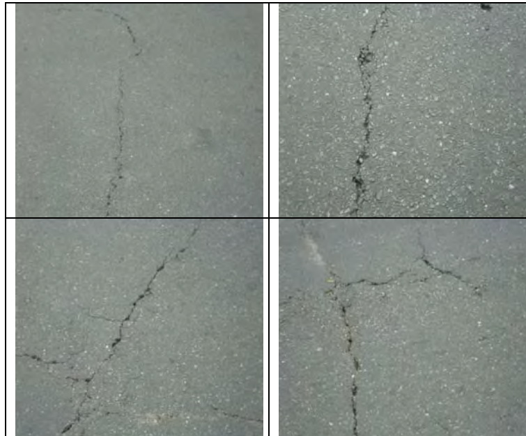
Cra100 frente a Kiamotor: Fisura en losa en ambas carriles a unos 100 mts de la estación Univalle.
