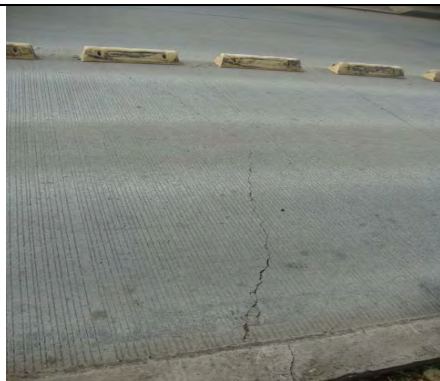
Calzada oriental carril sólo bus, frente al N° 74-102. Fractura de losa de concreto
