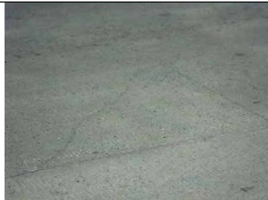
Calzada occidental carril mixto, frente al N° 73-11. Fractura de losa de concreto
