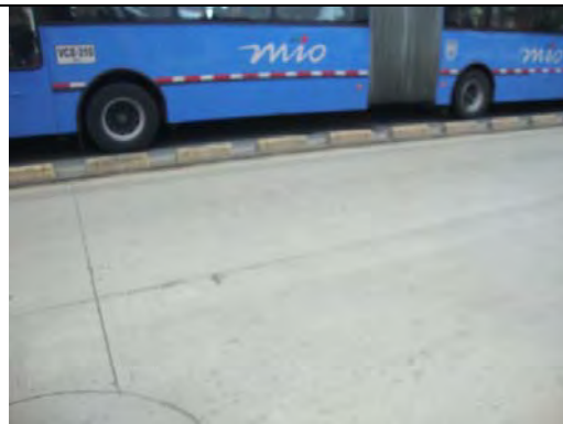
Calzada occidental carril mixto frente al N° 71A-57. Fractura de losa de concreto
