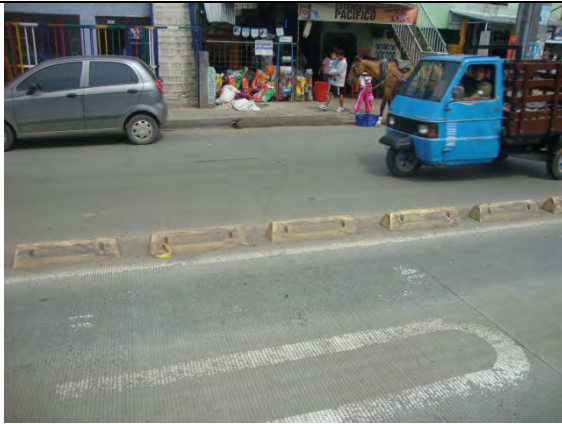
Calzada occidental carril mixto frente al N° 72B-77. Fractura de losa de concreto
