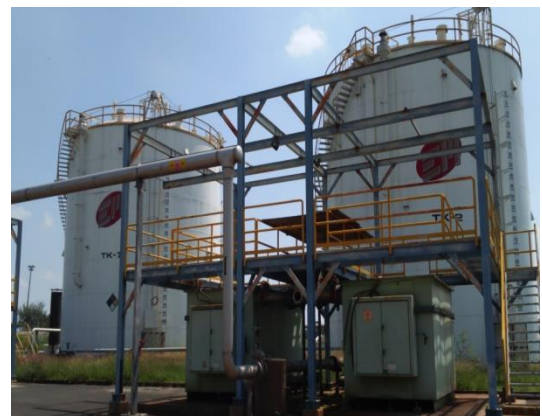
Generadores de Biogás
