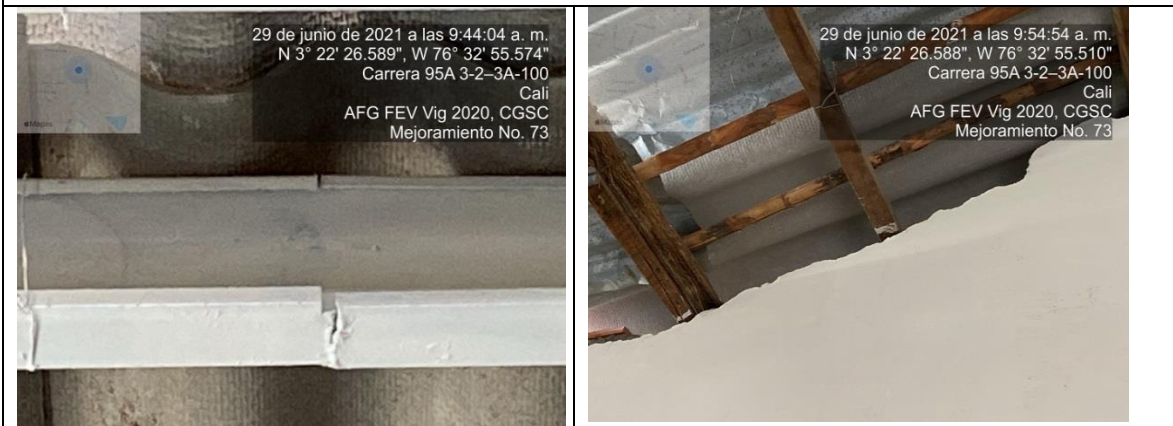
Mejoramiento No. 73, se evidencia mala calidad en los empalmes de los perlines de la cubierta y el remate de los filos de los muros, en el informe de interventoría se registran actividades no ejecutadas en la vivienda o ejecutadas en menor cantidad de las reconocidas, a saber:
