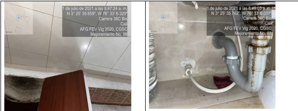
Mejoramiento No. 88, Las cantidades de obra relacionadas en informe de interventoría son congruentes con las cantidades de obra realmente ejecutadas, se observa exceso de estuco.
