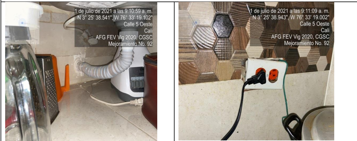
Mejoramiento No. 92, se observe que el tomacorriente instalado no cumple con el estándar además de exceso de estuco en conexión de desagüe del lavaplatos.
