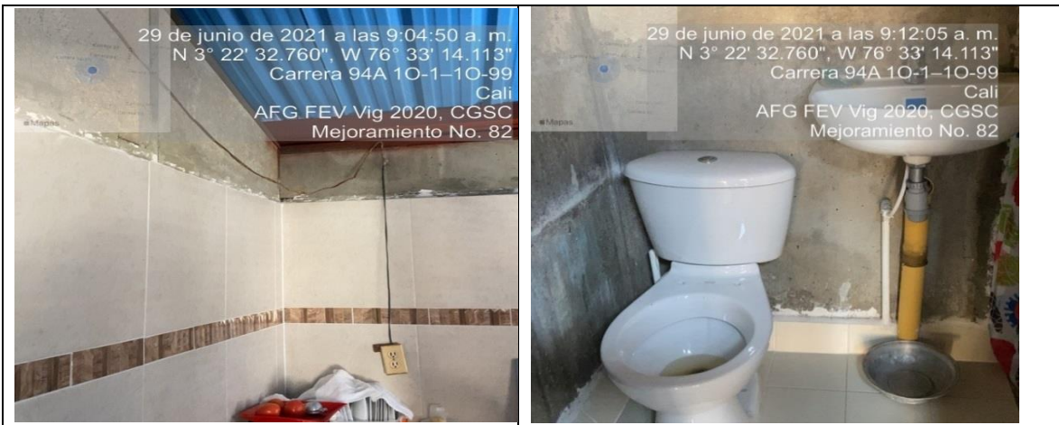
Mejoramiento No. 82, se evidenció mala calidad en el empate del tubo de desagüe del lavamanos.
