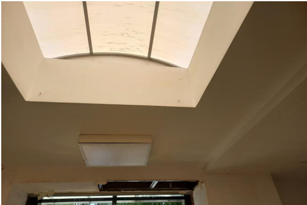
Humedad corredor ingreso al Auditorio CALI 17
