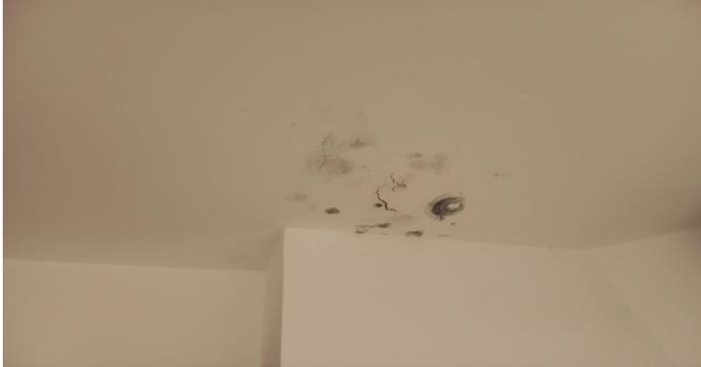
Humedad del techo entrada auditorio
