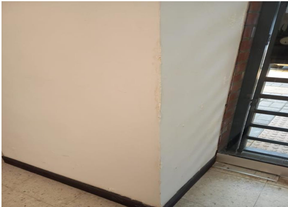
Humedad pared ingreso al CALI 17
