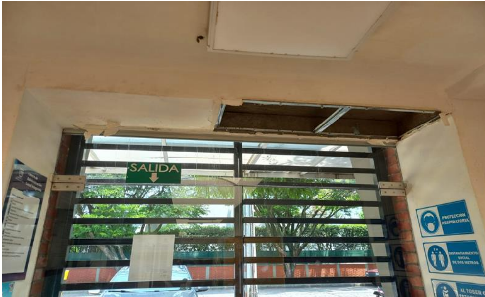
No existe láminas en el cielo raso y hay humedad
