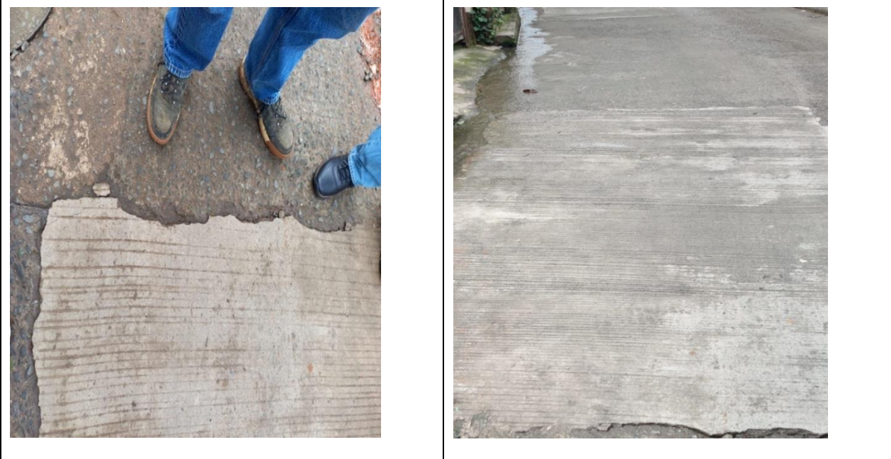
Registro de las fisuras en la unión del concreto endurecido y el concreto fresco.
