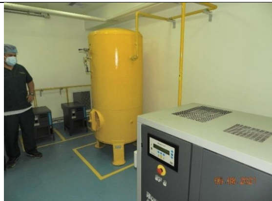
Clínica Unidos por la Vida. Construcciones de muros interiores en board y superboard con su respectiva estructura metálica de soporte, estuco y pintura. Área del tanque de oxígeno en el sótano.
