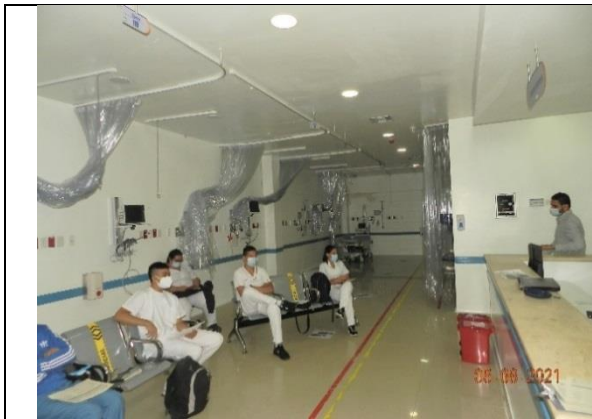
Clínica Unidos por la Vida, resanes de muros interiores, estuco y pintura, suministro e instalación de cortinas transparentes
