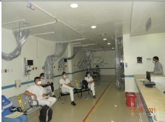
Clínica Unidos por la Vida, resanes de muros interiores, estuco y pintura, suministro e instalación de cortinas transparentes
