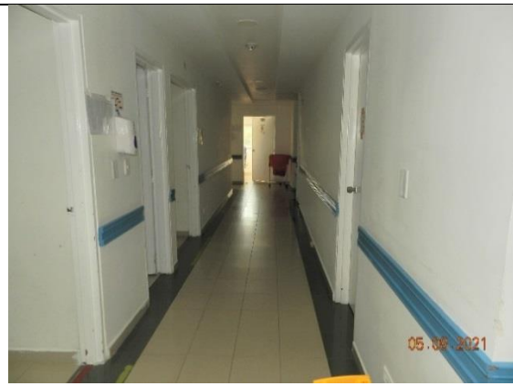
Clínica Unidos por la Vida, resanes de muros interiores, estuco y pintura en pasillos, pintura de puertas de madera, cambio de cerraduras para puertas de habitaciones
