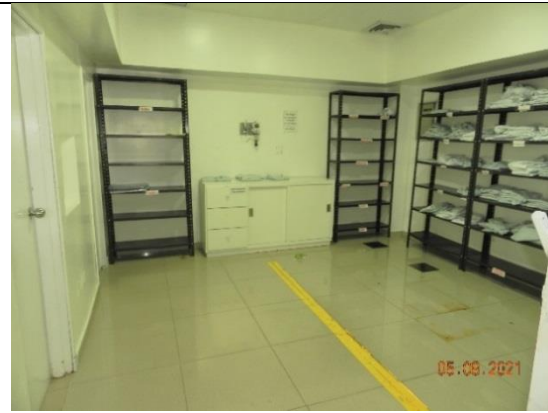
Clínica Unidos por la Vida, resanes de muros interiores, estuco y pintura, pintura de soportes metálicos
