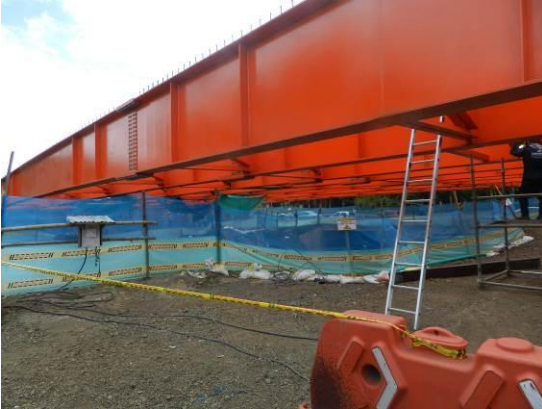
Puente vehicular río Lili. Vigas metálicas izadas y actividades previas de instalación de encofrado para fundición del tablero
