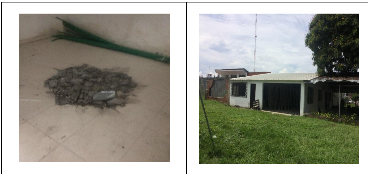
Imagen 3. Escombros dejados por la actual obra e instalación de tejado.
