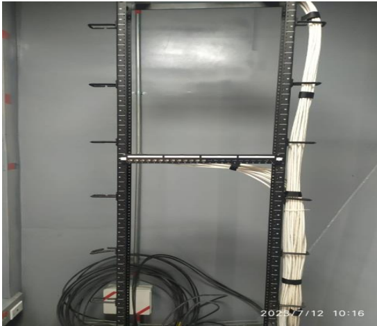
Foto 3. Estación 17 – Cuarto Técnico.
