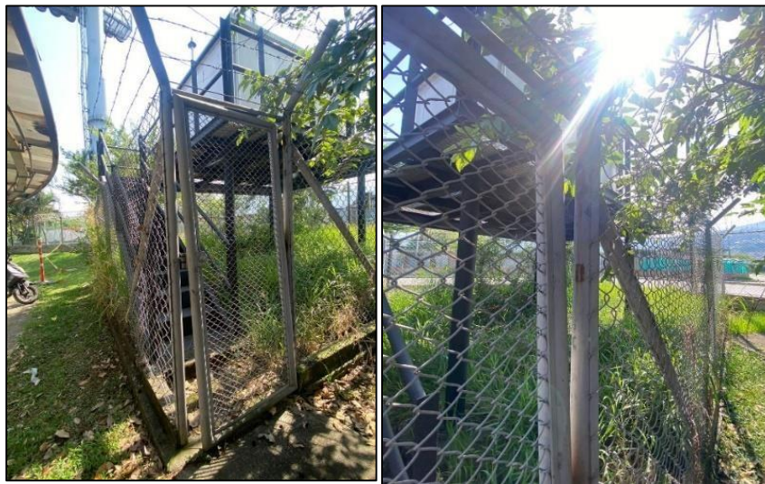
Ilustración No. 10 Estado de la estación de Cañaveralejo
